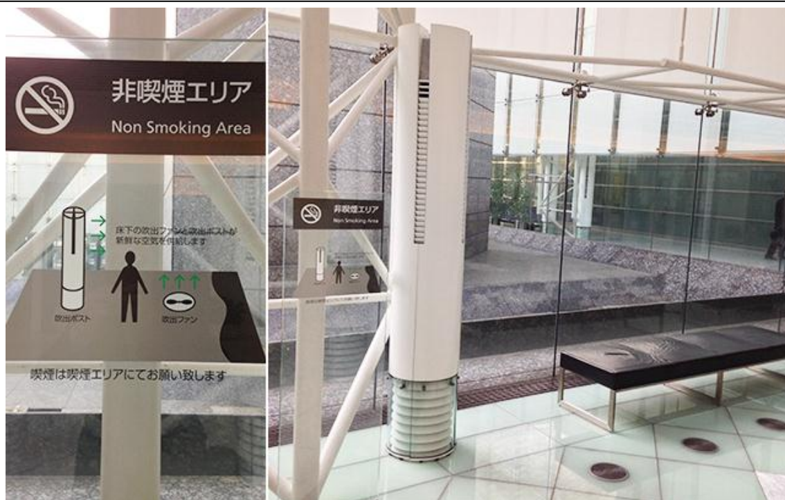
●同ロビーの非喫煙エリア。空気吹出口はこちらの床にもある。円柱もこちらでは空気吹出口となっている。
