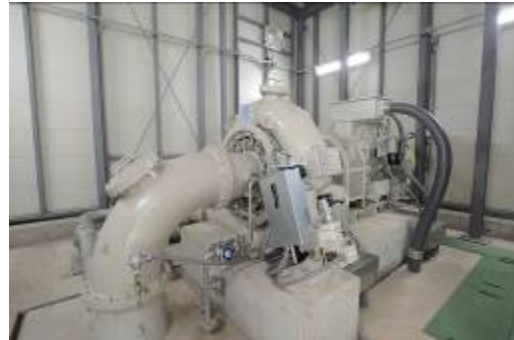
発電所内（水車発電機）
