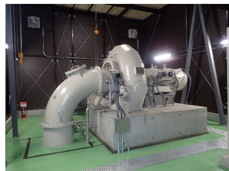
発電所内（水車発電機）
