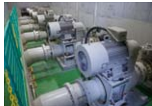
第四発電所 発電機
