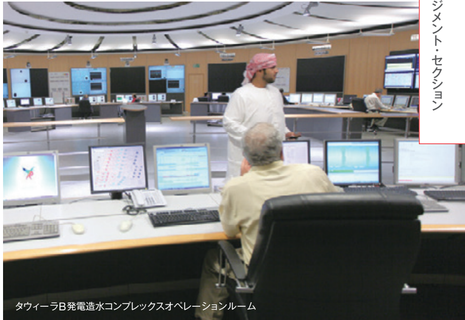
2008年10月から商業運転を開始したタウィーラB発電造水事業(UAE)夜景
