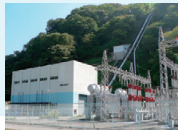
三峰川水力発電所
