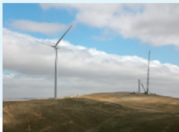
ハレット4風力発電所
