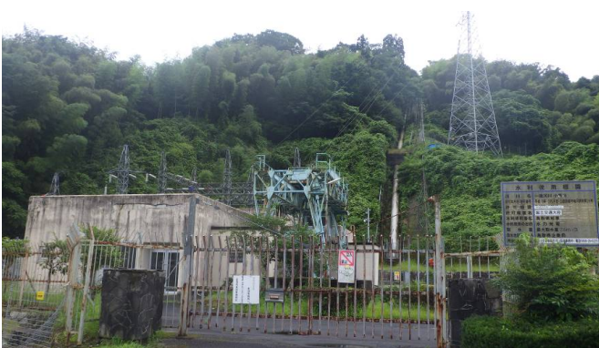
小鹿第二発電所
