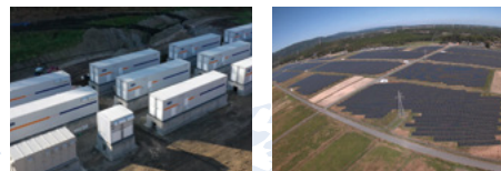
定置用蓄電池
