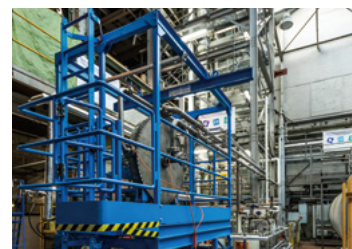
英国 Carbon Clean Solutions Ltd.の次世代型CO 2 分離・回収設備
