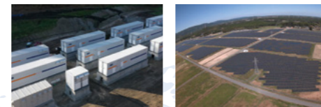
定置用蓄電池
