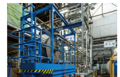
英国Carbon Clean Solutions Ltd.の次世代型CO 2 分離・回収設備
