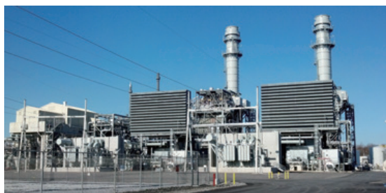
ウェストデプトフォード天然ガス焼き火力発電所(米国)
