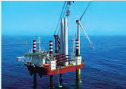
2012年に買収したシージャックス社による洋上風力発電所据付工事(英国)
