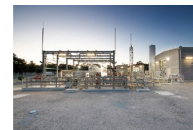
水素液化設備・積荷基地(豪州)(HEA社提供)
