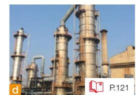
英国Carbon Clean Ltd.のCO 2 分離・回収技術を利用した設備
