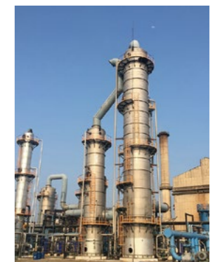
英国Carbon Clean社のCO 2 分離・回収技術を利用した設備
