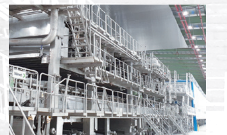
KRAFT OF ASIA PAPERBOARD & PACKAGING CO., LTDにて建設中の生産設備
