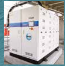
宮城県富谷市水素サプライチェーン事業(水電解装置)
